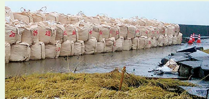
▲金沢区福浦・幸浦地区の崩壊した護岸の代替として積まれた土嚢
